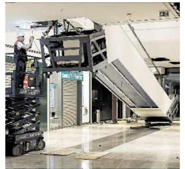
Das obere Ende der Rolltreppe war an einem Kran befestigt. FOTO PIEPER
